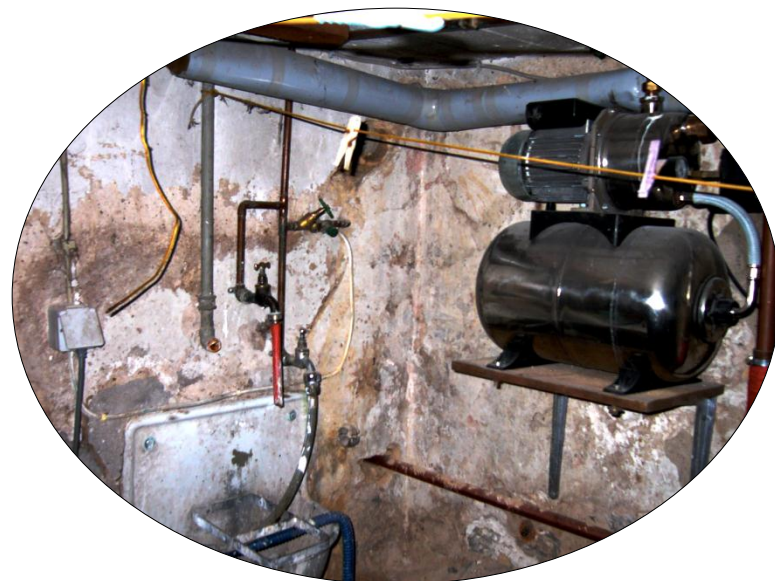
Oštećenja izazvana rastućom vlagom
