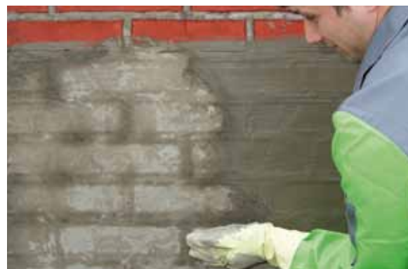
Das KÖSTER Kellerdicht 2 Blitzpulver wird per Hand in die frische, nasse Schlämme eingerieben, bis die Fläche trocken ist.
