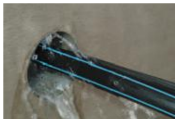
Wassereintritt an einer ...
